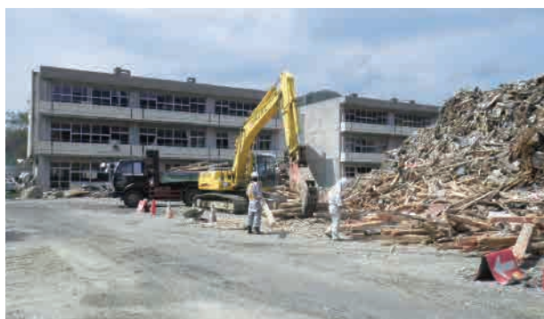
■被災した赤崎小学校に設置された仮設のガレキ置き場(平成23年度)
